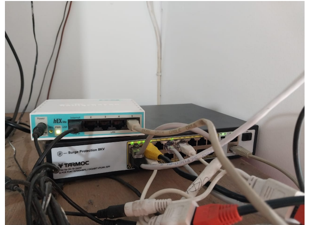
Gambar 7. Instalasi Perangkat Switch
