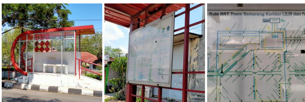
Gambar 1 : Kondisi halte yang steril dari informasi dan yang mulai rusak (tengah dan kanan)
