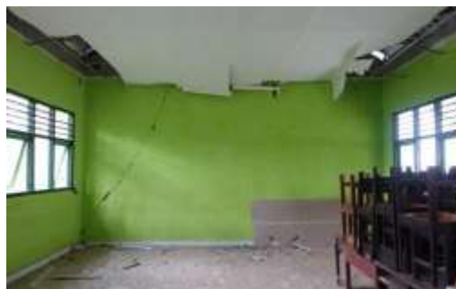
Gambar 5: Ruang Kelas Yang Hancur Akibat Gempa Lombok
